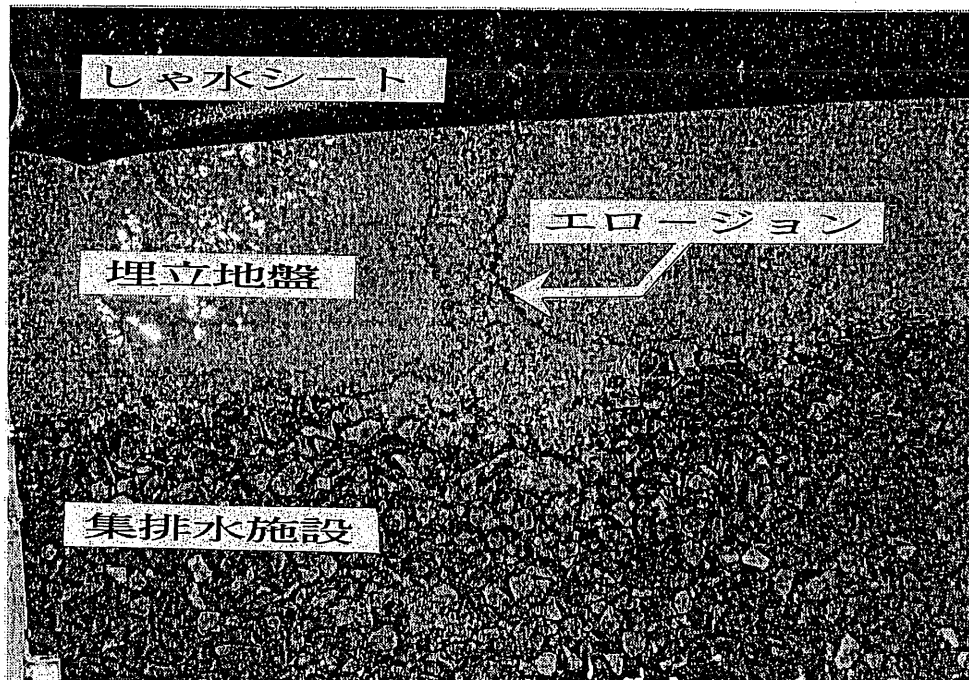
写真-1 埋立地盤表層でのエロージョン
